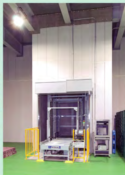
※1F防火シャフト内設置
